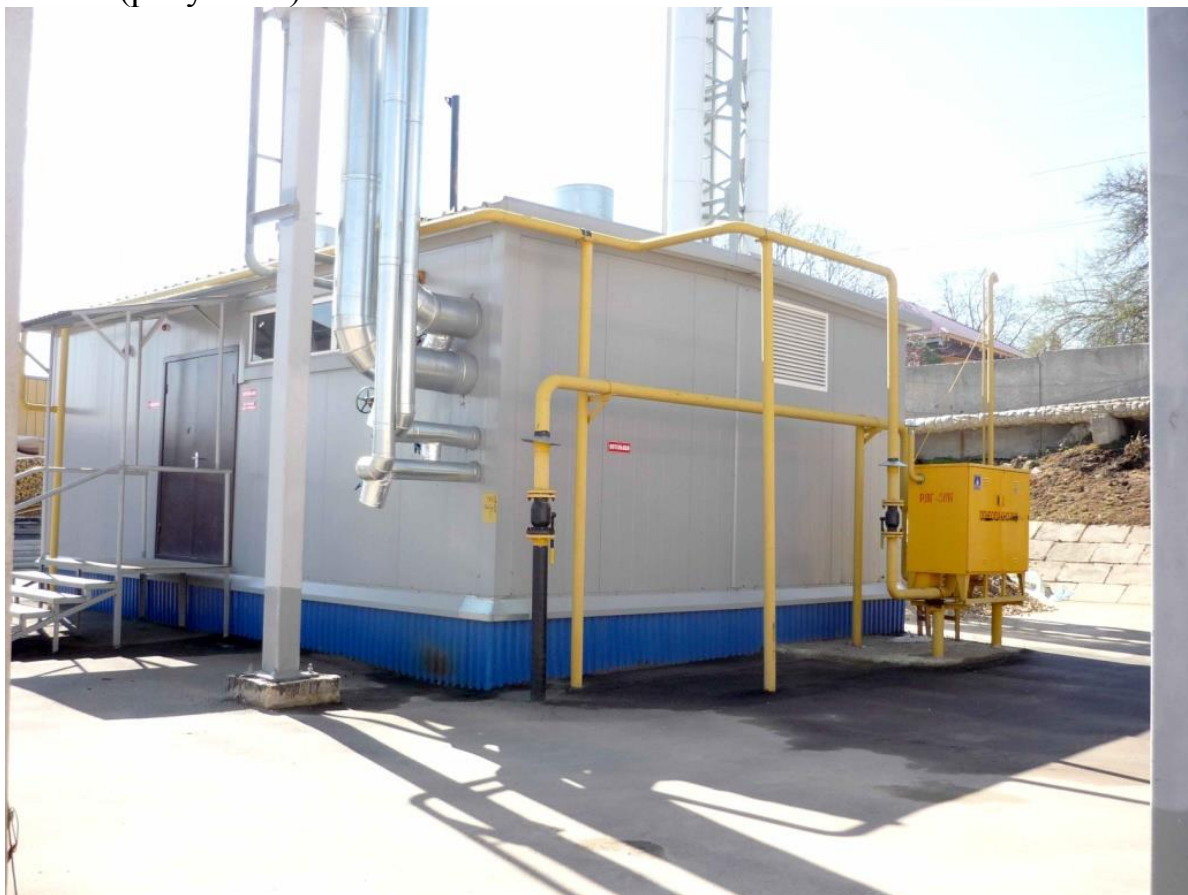
Рисунок 2 Модульная газовая котельная на территории «ИсетьЛесПром»
